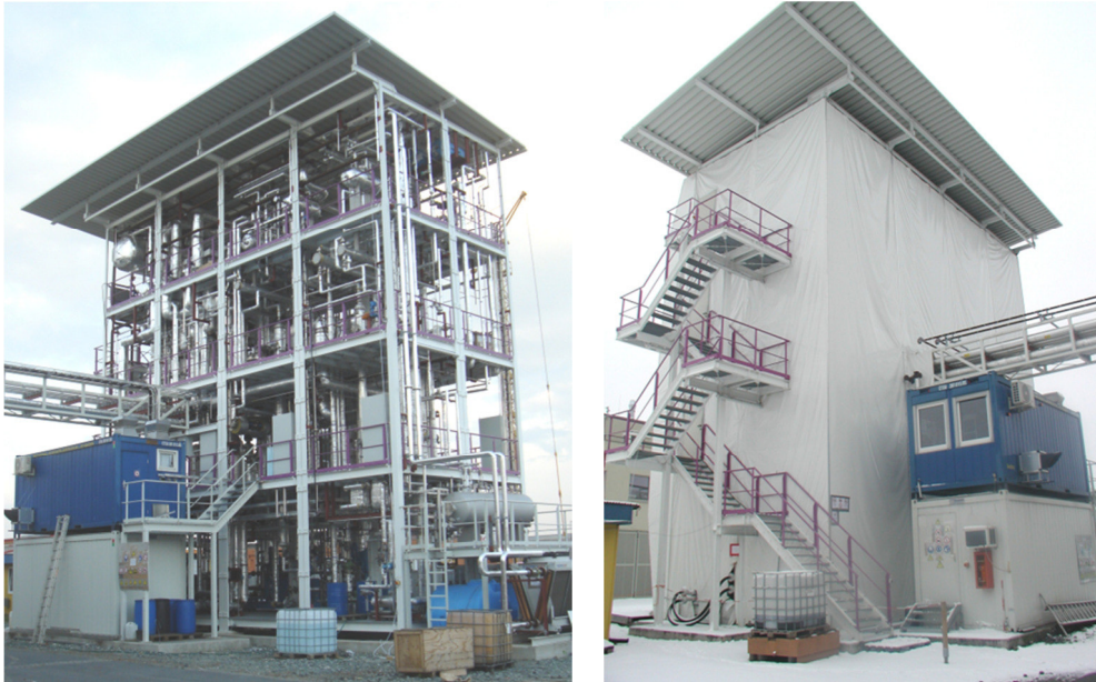
Abbildung 6: 1MW BioSNG Pilot- und Versuchsanlage
